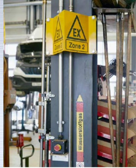
Tubazioni di sfianto e sensori gas
