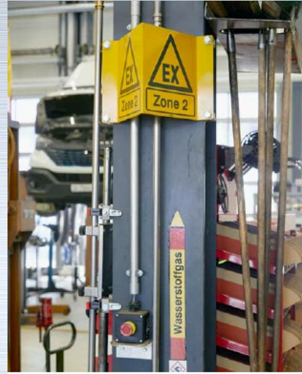
Entlüftungsleitungen und Gas-Sensoren
