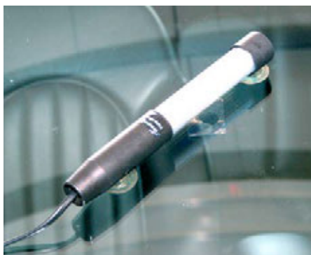
Bild 4. Der Finisher befindet sich zwischen Folie und reparierter Schadstelle. Mithilfe der UV-Strahlung wird das Harz ausgehärtet. Die UV-Lampe wird für maximal 10 Minuten eingeschaltet.
