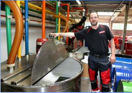
Stephan Lämmle devant l'installation de mélange comprenant les trois réservoirs de 6000 litres.
