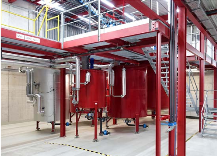
Le mélange se fait de manière entièrement automatique.
