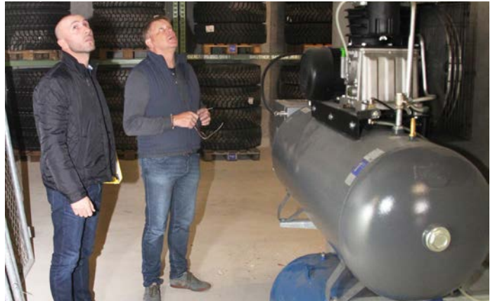
L'agrégat de pompage et le réservoir se trouvent au sous-sol.
