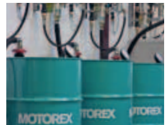
Eine moderne Fluidversorgungsanlage gehört zu einem effizientem Betrieb.
