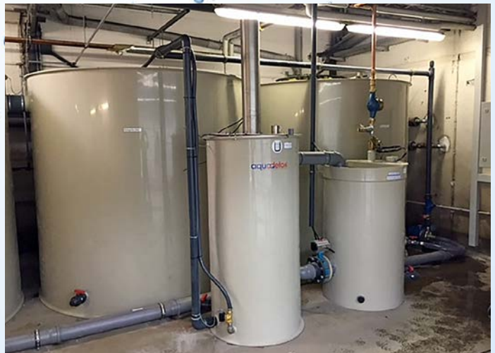
Dank einer Bio-Simplex-Abwasserreinigungsanlage kann die Waschanlage auch bei Wassermangel verwendet werden.
