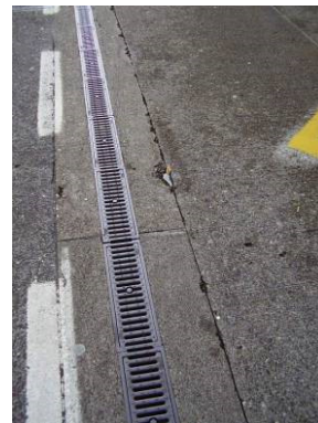
undichte Fuge vor Entwässerungsrinne ✘
