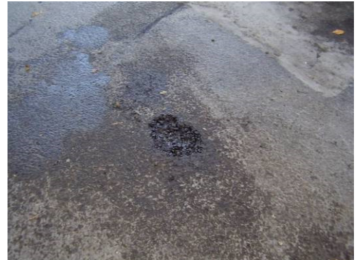
flächige Beschädigung auf Betankungsplatz
