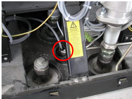
Säulenfuss nicht abgedichtet (Elektrokabel)
