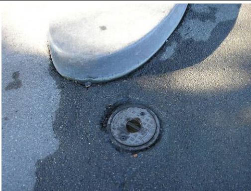
undichter Bereich um Schacht ✘
