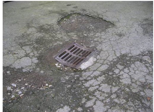
grossflächige Beschädigung bei Einlaufschacht
