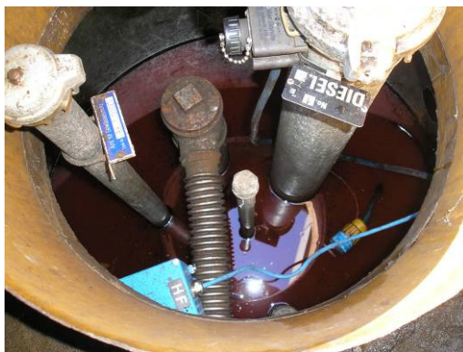
Domschacht voll Wasser / Flüssigkeit
