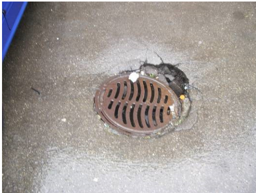
flächige Beschädigungen bei Einlaufschacht
