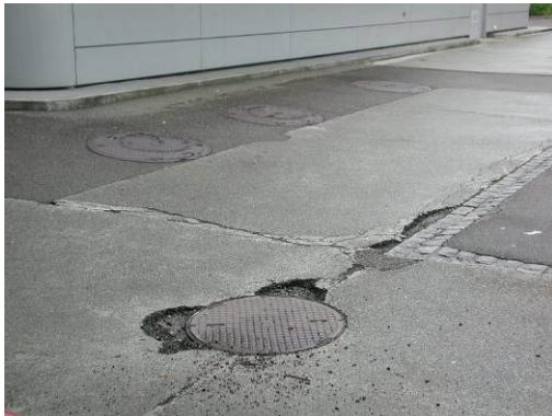
flächige Beschädigungen auf Umschlagplatz
