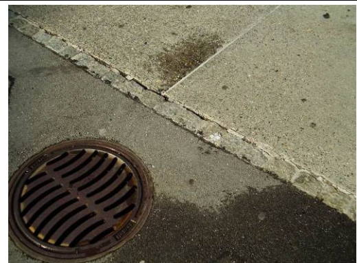
undichte Fuge Übergang Beton-Asphalt ✘
